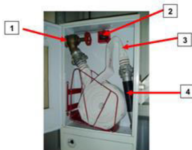
Рисунок 7 Внутренний пожарный кран
